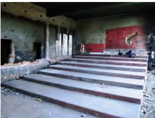
写真-3 旧キンシャサ保健人材センター内部 略奪により崩壊した旧校舎は手付かずのまま放置されていた。
