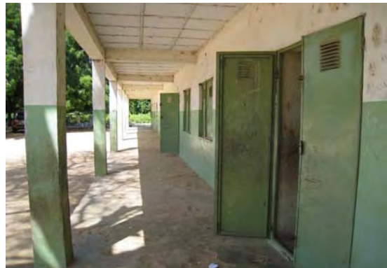
廊下 （床がかなり損傷）
