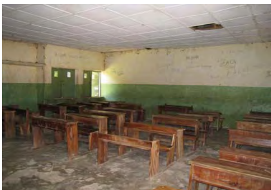
教室内部 （床仕上げの損傷が目立つ）
