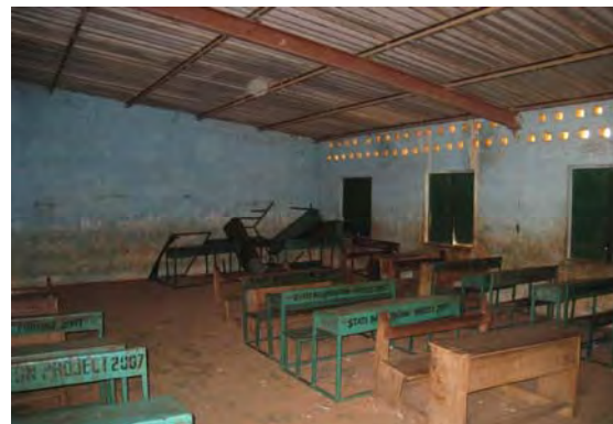
屋根下地が鉄骨造の教室内部 (古い建物だが、屋根や内装に損傷が少ない)
