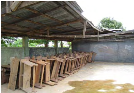
屋根が著しく損傷している教室棟
