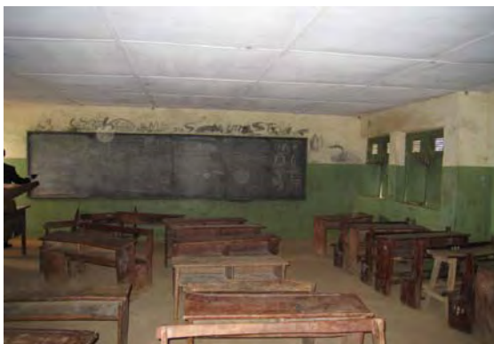
教室内部 （室内の損傷が少ない）
