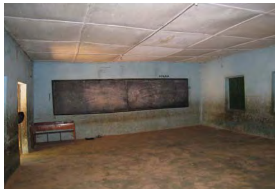
教室内部 (建具に損傷が見られるが、内装の状態が良い)
