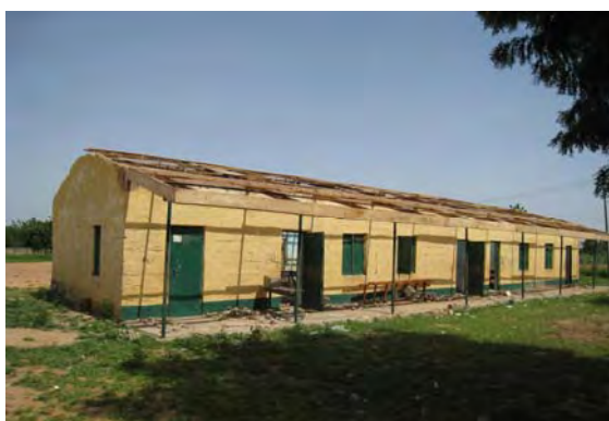
2008 年 6 月に強風被害を受けた教室棟
