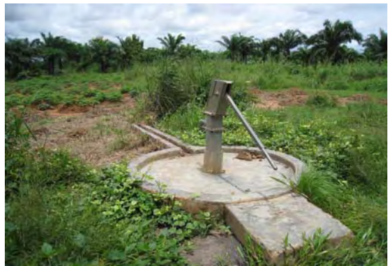
故障して使えない学校用の井戸 （建設年不明）
