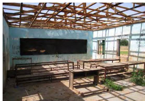
屋根が飛ばされた教室内部
