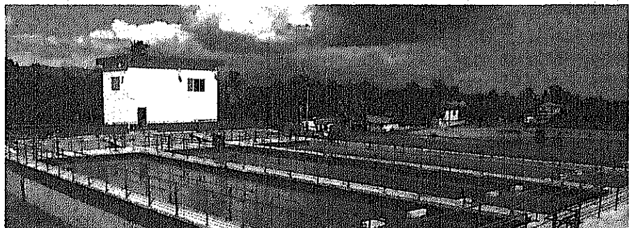
Planta potabilizadora de Spanish Town construida con los fondos del Préstamo en Yenes. Su construcción se terminó en agosto de 2008.
