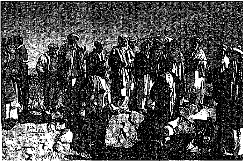
Observación de las obras del sistema de riego que se construye en el marco del Proyecto de Apoyo al Desarrollo Regional (en la región central de la provincia de Bamiyán, Afganistán.)
