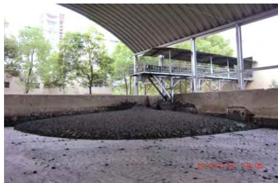
3. 第2下水処理場（脱水汚泥）
