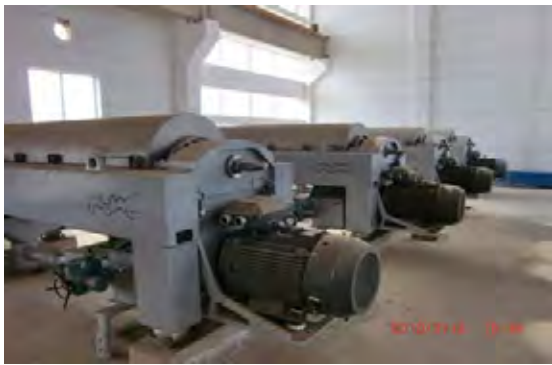
9. 第7下水処理場（汚泥脱水機、デンマーク製）
