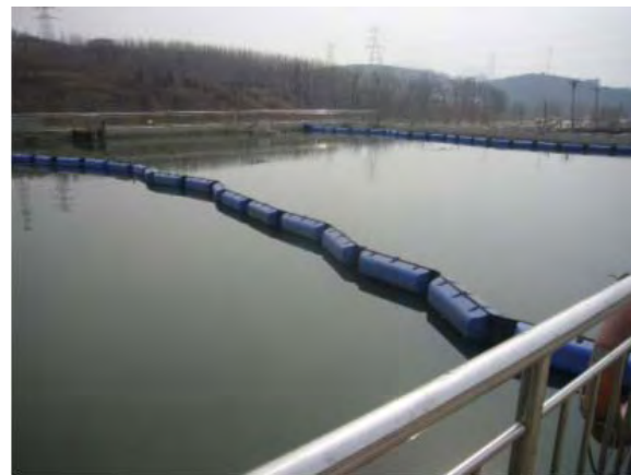
4. 東泰・夏家河污水处理場 （回分式活性汚泥法／沈降プロセス）
