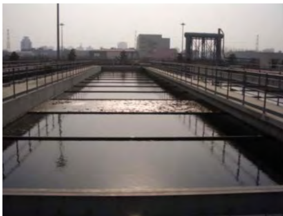
5. 清河污水处理場（長い終沈。一部でスカム発生）
