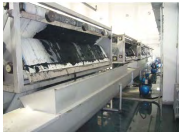
6. 咸陽路污水处理場 （フィルタープレスのケーキ(搬出处分)）
