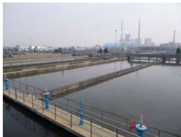
4. 高碑店污水处理場（火力発電所近接）
