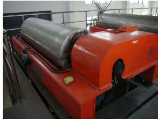
4. 南汇污水处理場（遠心脱水機）
