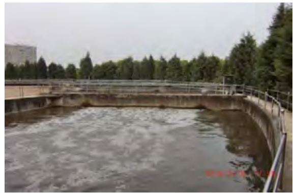
2. 第2下水処理場（曝気槽）
