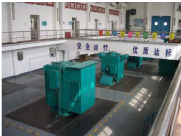
3. 高碑店污水处理場（日本製ポンプ）
