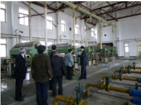
3. 紀庄子污水处理場（遠心脱水設備(修理中)）
