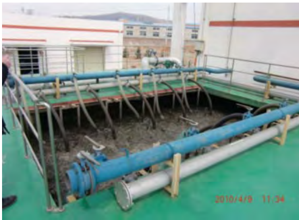
3. 清本再生水有限公司処理場 (膜分離活性汚泥)
