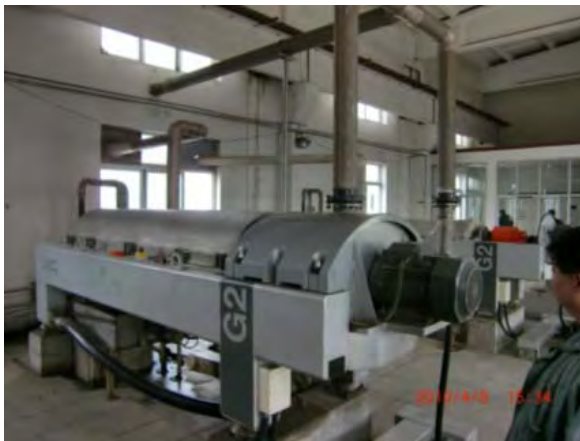
3. 咸陽路污水处理場（遠心脱水(前処理)）
