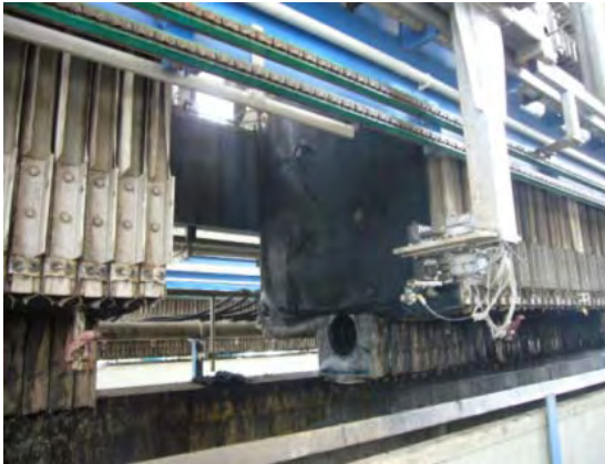
3. 南汇污水处理場（加压脱水機）
