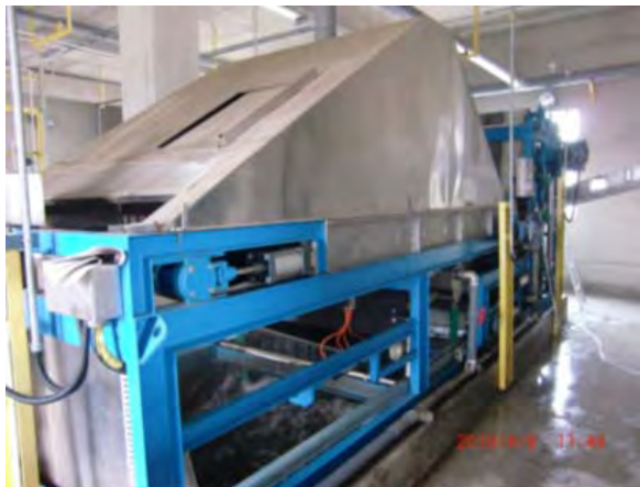
5. 清本再生水有限公司処理場 (ベルトプレス脱水機)
