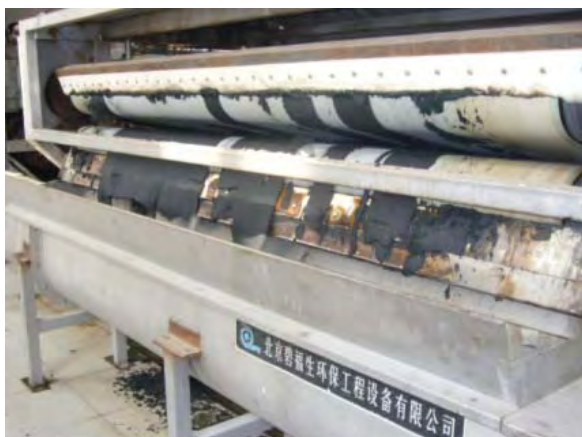
5. 高碑店污水处理場（フィルタープレス脱水）
