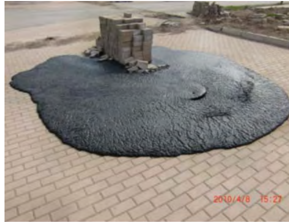
2. 咸陽路污水处理場（人孔から溢れた汚泥）
