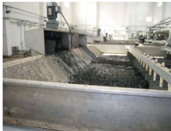
4. 咸陽路污水处理場（遠心濃縮汚泥の流入→フィルタープレスへ）
