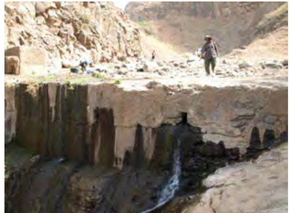
Dique de Captação de Água Corriente Subterrânea
