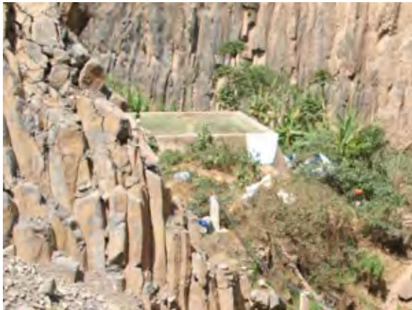
集水ダム下の貯水槽
