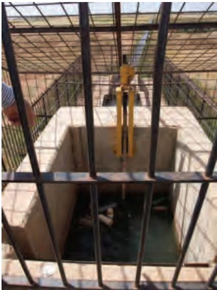
写真 2-2-9 幹線水路から支線水路へ分水ゲート
