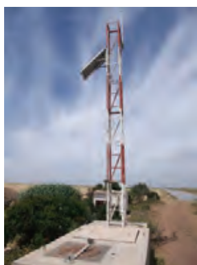
写真 2-2-13 水位調整施設そばのデータ送信アンテナとソーラーパネル
