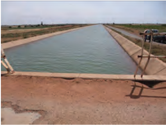
写真 2-2-7 幹線水路（高位部灌漑地域第 1 期灌漑地区）
