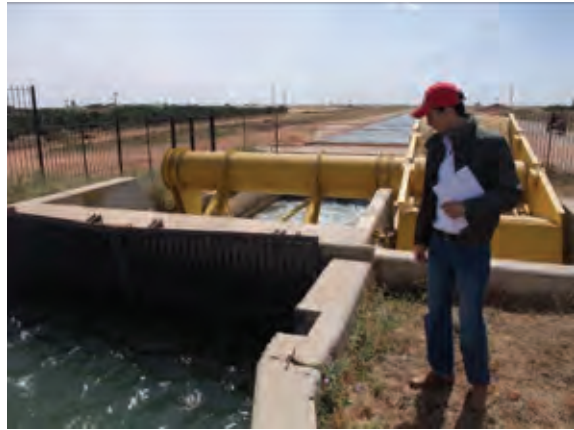
写真 2-2-8 幹線水路に設置された水位調整ゲート
