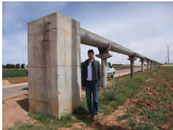
写真 2-2-10 アフリカ開発銀行融資地区の高架式水路の一例
