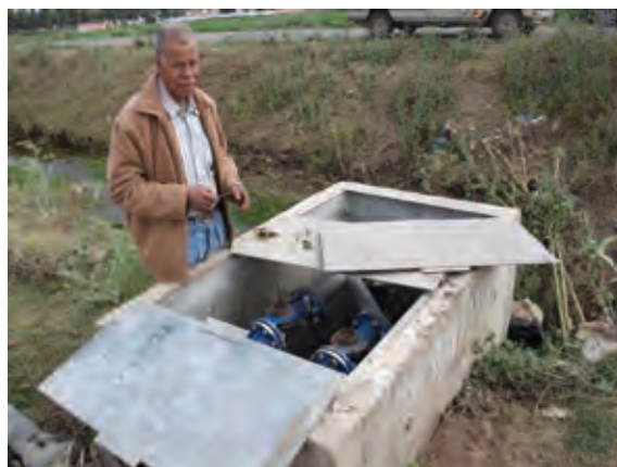
写真 2-2-26 壊された流量計のチェックを行っている職員
