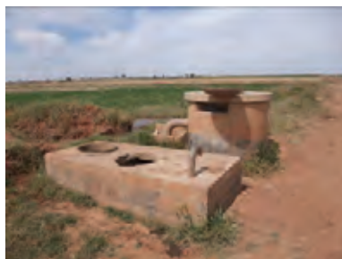
写真 2-2-16 低圧管路地区の給水栓（立ち上がり管）
