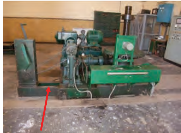
写真 2-2-2 低位部灌漑地域用のゲート操作機器（ゲートは下部にある）
