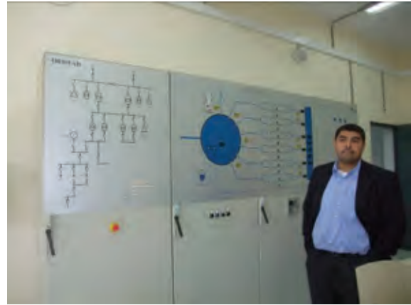
写真 2-2-4 ポンプ場モニタリングパネル
