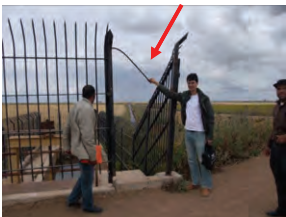
写真 2-2-23 幹線水路から二次水路への取水ゲート部防護柵の扉部分が破壊されて、なくなっている。
