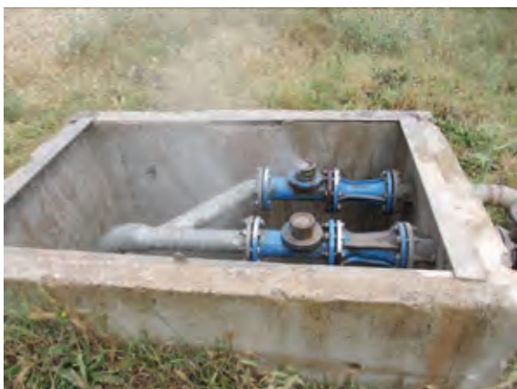
写真 2-2-25 破壊され、水が噴き出している流量計
