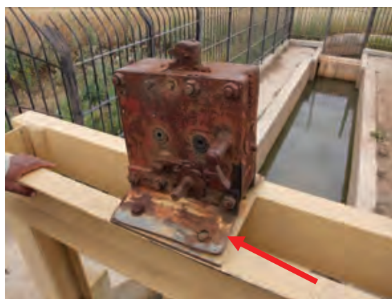
写真 2-2-24 同左地点のゲート操作装置の土台との接続部がねじ曲がっている。
