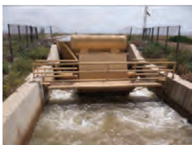
写真 2-2-12 幹線水路の水位調整施設
