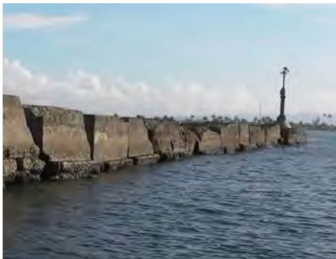
写真5 防波堤上部コンクリート (ルセナ漁港)
