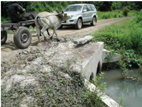
カルバート7。カルバート自身には問題はないが、前後及び上部の路面整備が必要。
