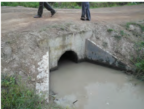
カルバート2。カルバート自身には問題はないが、前後の道路面の整備が必要。
