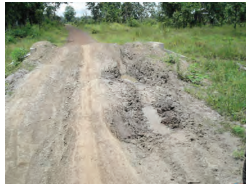
カルバート8。カルバート自身には問題はないが、前後の道路面の整備が必要。
