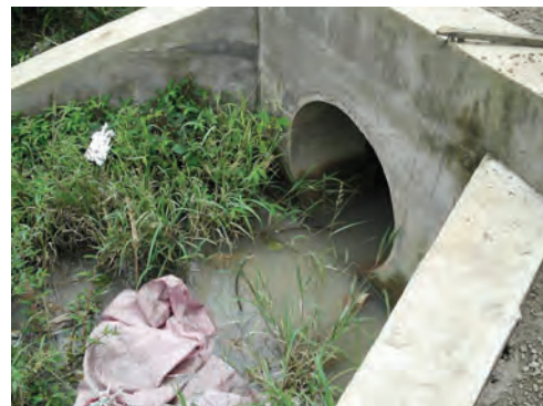
同左に敷設されたカルバート1。公衆道徳不足でゴミ捨て場化している現状。
