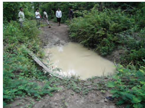
同左。カルバート敷設場所前後の道路面陥没箇所は修復が必要。
