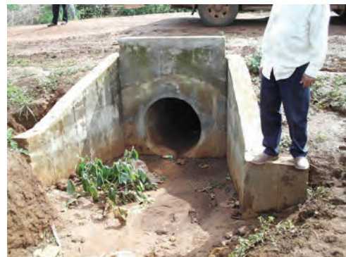
カルバート4。カルバート自身に問題はないが、接続する排水溝とのレベルが土砂等の堆積により吐水口レベルより高いため、逆流及び滞留するおそれがある。
