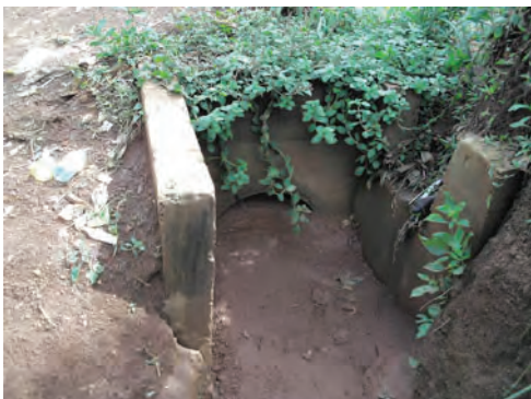
カルバート3。管内に泥が充満しており除去が必要。敷設位置が域内の最低レベルにあり、常時発生する危険性がある。域内の全体排水計画及び日常的な点検が必要と判断される。
