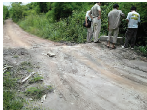
ベトナムに続く道路添いのカルバート3。重量車両通行による上部コンクリートの露出、端部欠損を確認。
