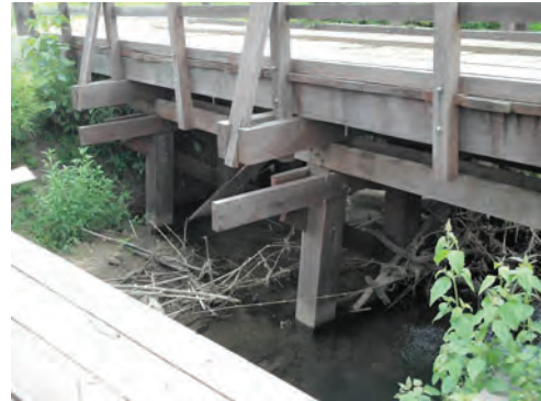
橋に問題はない。持続性確保のため接続道路の路面整備、川中の流木等の排除、重量制限表示等が必要。
