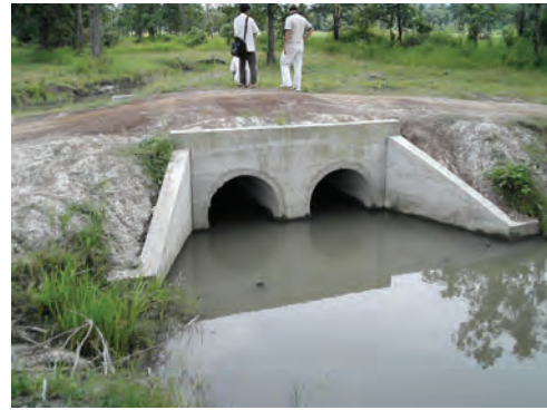
カルバート6。カルバート自身には問題はないが、前後の道路面の整備が必要。
