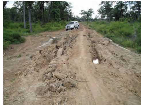
同左。前後及び上部の路面整備が必要。住民は、コミュニオンファンド利用による補修を思案中。
