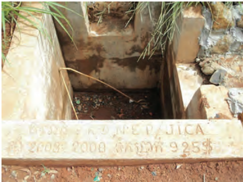
郡都内の道路に敷設されたカルバート1。泥が堆積しており除去が必要。
