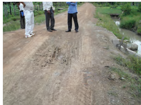
同左。車両の通過等により、路面がえぐれている状況。
