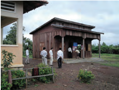
郡保健センター横に建設された職員用仮眠室。現地仕様による基礎・床コンクリートの木造施設。
