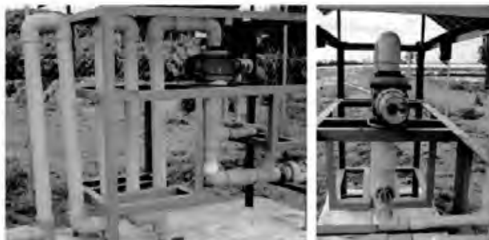
Monitor de flujo y calidad del biogas
