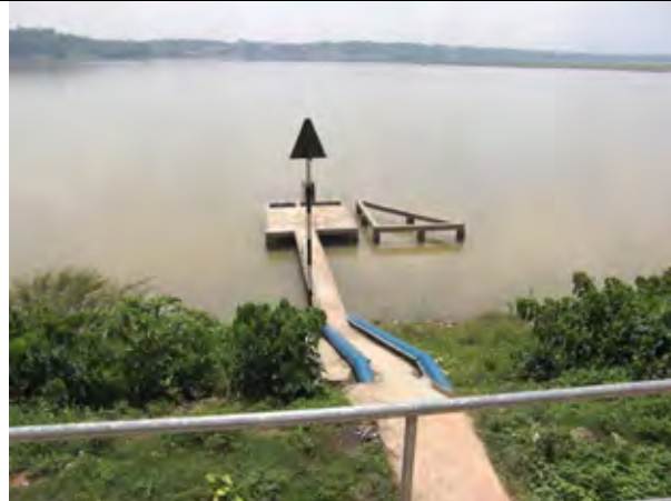
Công trình thu của nhà máy xử lý nước hiện tại tại sông Đà
