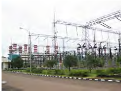
Gambar 3.6-2 Instalasi Pembangkit GT/CC dan Gardu 500kV
