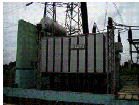
Gambar 3.6-19 Trafo utama 500/150kV
