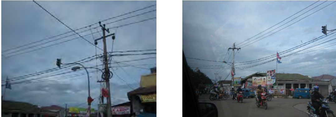
Gambar 3.6-25 Instalasi Distribusi 20kV di sekitar Jakarta
