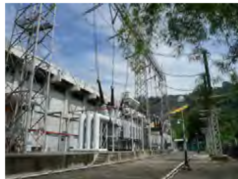
図 3.6-13 16.5/500kV 主要変圧器
