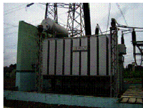
図 3.6-19 500/150kV 主要変圧器
