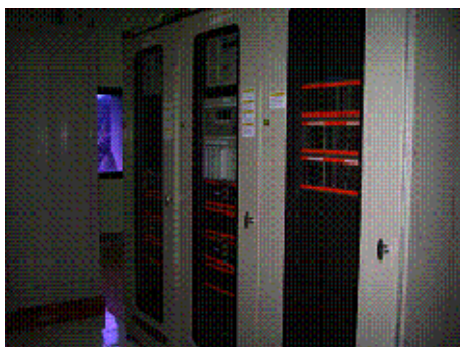
図 3.6-20 500kV 系統の保護リレー
