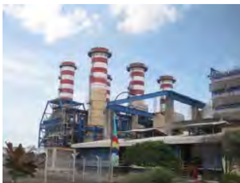
図 3.6-5 CC 発電設備
