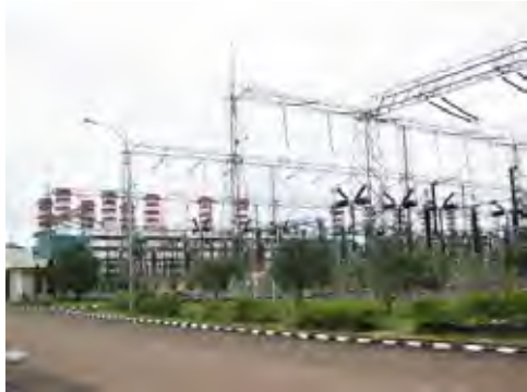
図 3.6-2 GT/CC 発電設備と 500kV 開閉所
