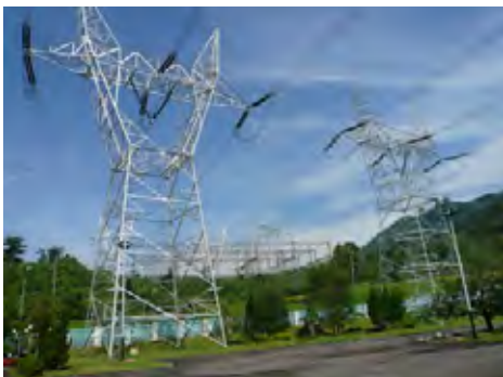
図 3.6-14 屋外 500kV 開閉所
