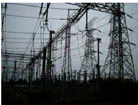
図 3.6-18 500kV 送変電設備
