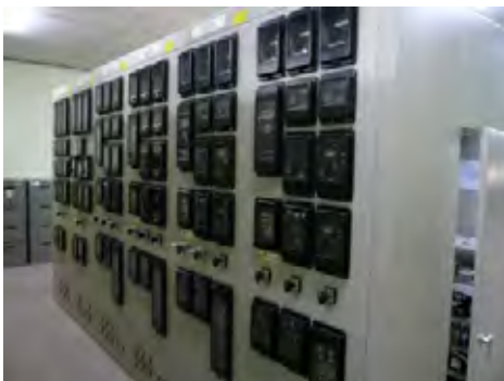
図 3.6-12 保護リレー盤
