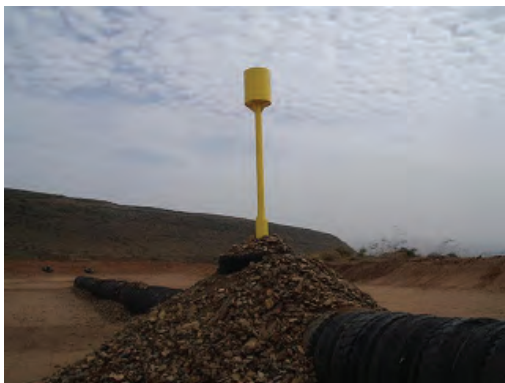
写真3-28 新規処分場（集ガス管）
