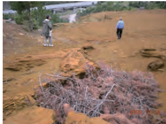
写真 5.6.14 No.3 堆積場下部の浸食
