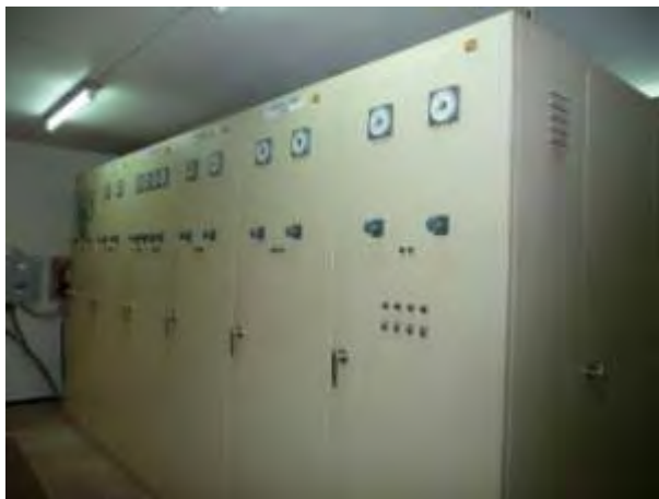
既存の電気設備の様子（配電盤） 低圧（415V）の配電盤。
