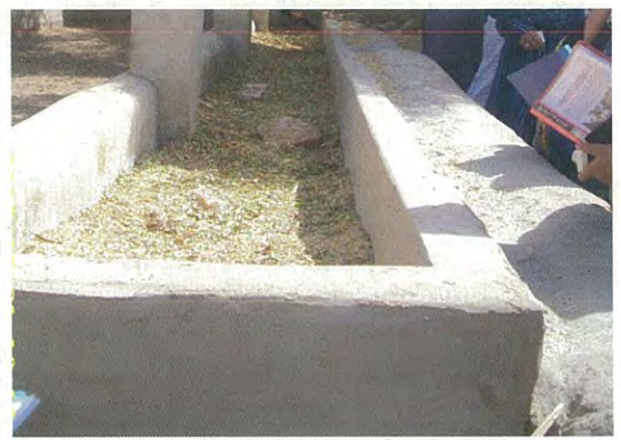
PDDC 畜舎内に設置した餌場
