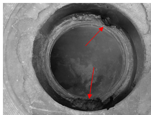
キャビテーションによる破損
