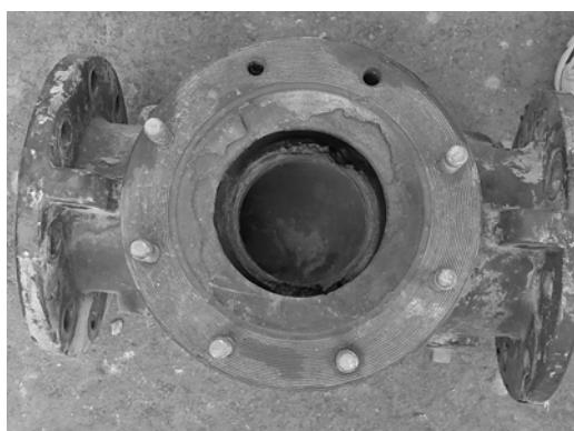
写真1 キャビテーションによる破損
