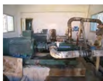
エラワスポンプ場 使用済みの機材を修理設置、水漏れ 等があり老朽化が著しい
