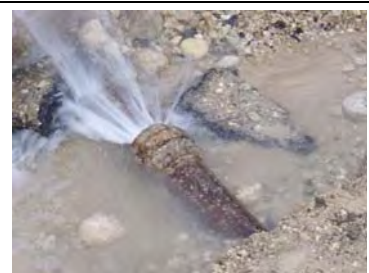
タフィーラ市内の漏水 (継ぎ手破損)
