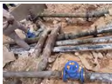
複雑な露出分岐配管
