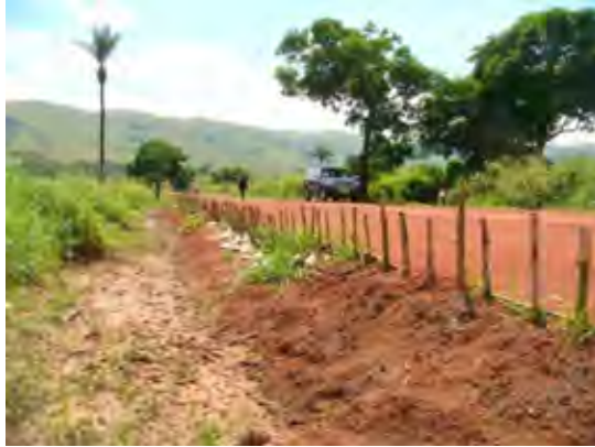
【Photo 7 – 2 ème jour de stage (cours pratique)】 Avant la réparation (le talus s’est effondré à cause de l’inondation)
