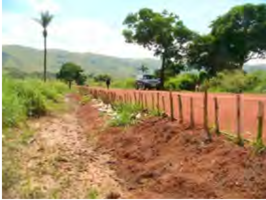
【写真-7 研修 2 日目（実技）】 改修前（洪水によって法面が崩れている）
