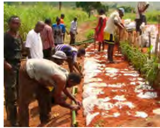
【写真-11 研修 2 日目（実技）】 コンパクションによる土のうの締め固めと、竹を利用した土留めを設置する参加者たち
