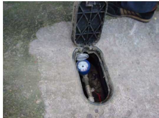
KfW プロジェクトで設置された給水メーター
