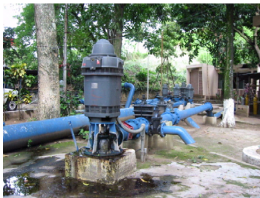
西部支局敷地内の井戸揚水ポンプと配水管
