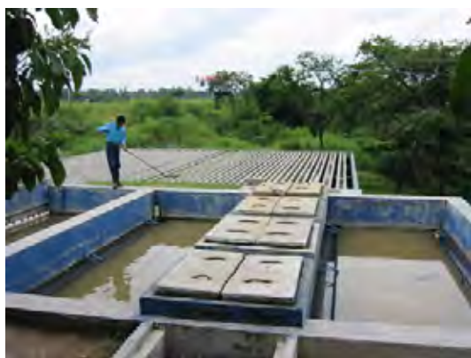
デベロッパーが建設し ANDA が維持 管理をしている市内の下水処理場 （手前が最初沈殿池、奥が散水ろ床槽）
