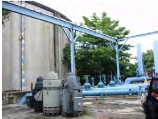
サンラモン A の井戸揚水ポンプと貯水タンク （貯水容量：20,000m 3 ）
