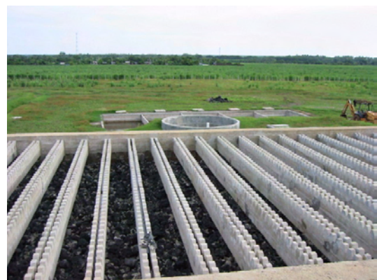
スペインの援助で建設中のプエルト・ エル・トゥリフォ市の下水処理場 (手前が散水ろ床槽、奥が最終沈殿池)
