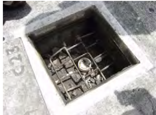
給水メーターボックス内に取り付けられた盗難防止のための鉄格子
