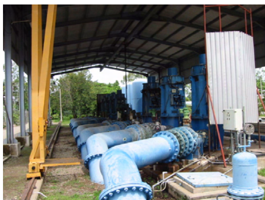
レンパ川浄水場の配水ポンプ
