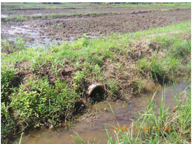
対象地域の一般的な水路 の現状
