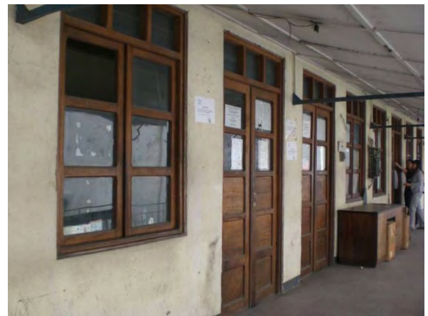
壊れて落ちそうな保健省事務所の廊下
