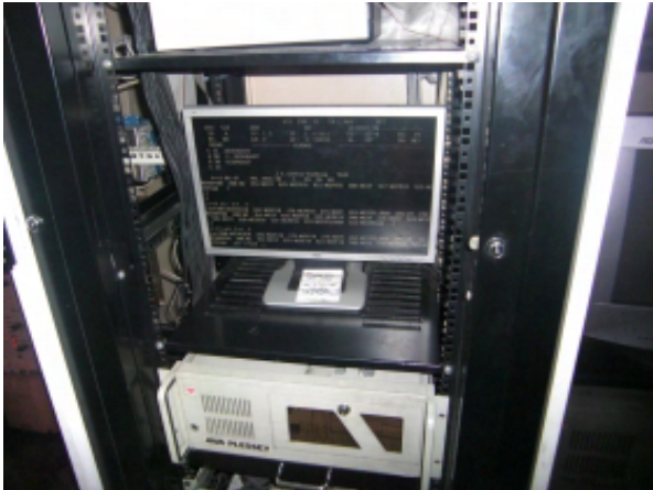
信号機管制室 (モニタリング PC)
