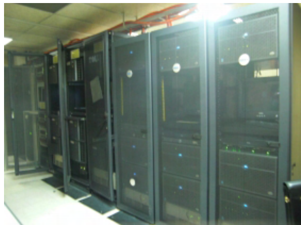
DPWH サーバー管理室 (5 階)
