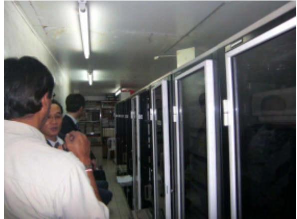
信号機管制室
