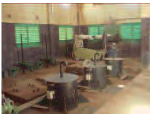
ポンプ場内部
