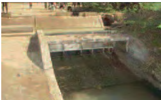
幹線水路流末の分水施設
