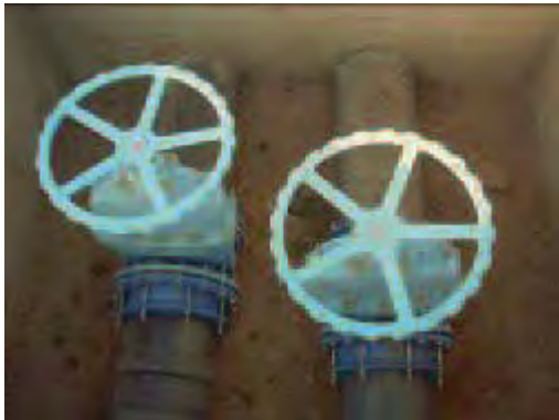
導水管のバルブ
