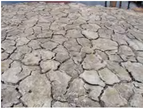
Case-0; 11/7 時点 (施工後 12 日目) クラックの深さは約 20cm
