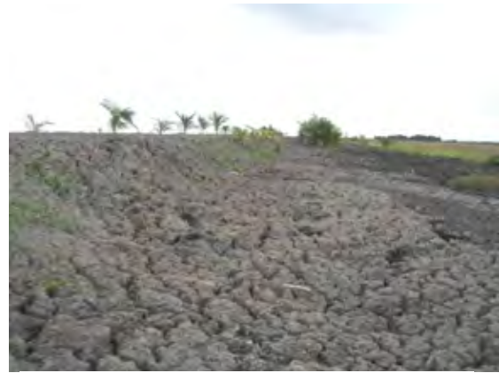
NDIA 施工部のクラック発生状況
