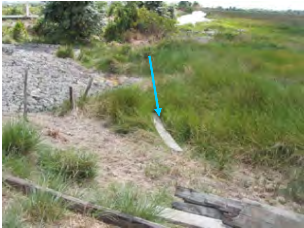
No.1 Point (浸透水の水溜まり・東側堤背面)
