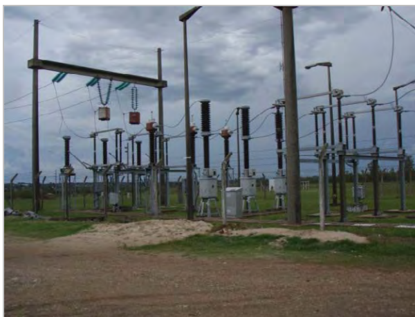
サルト変電所全景
