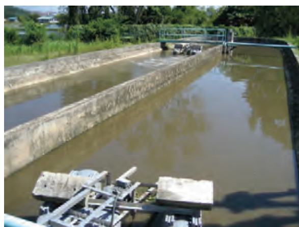
キング・フィッシャー団地処理施設 (下水の流入はなく、バツ気装置は停止中)
