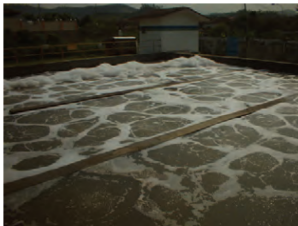
タマン・カンタン・ペルマイ処理場 (活性汚泥法 Activated Sludge : AS)
