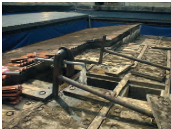
ケポン・バルー団地処理施設 (腐敗槽、Imhoff Tank : IT)
