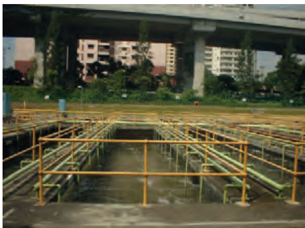
デサ・ハータマス処理場 (回分法、Sequential Batch Reactor : SBR)
