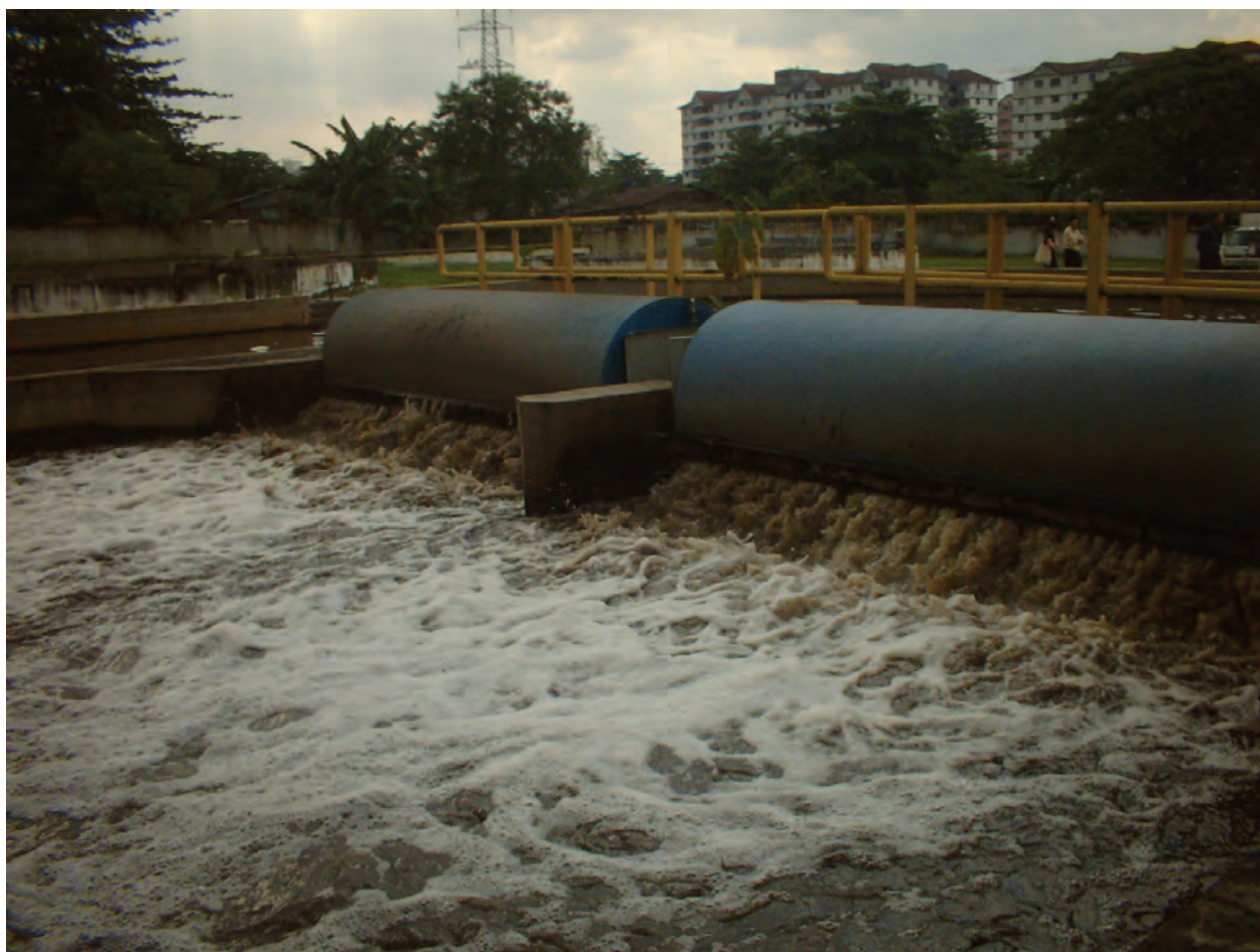
マスティアラ処理場 (オキシデーション・ディッチ OD : Oxidation Ditch)
