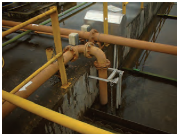
タマン・オーキッド処理場 (長時間バツ気法 Extended Aeration : EA)
