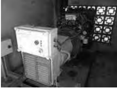
自家発電機 (用途不明)
