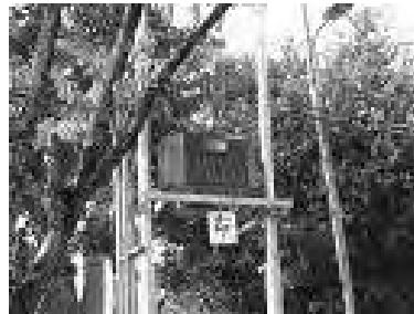
電力引込・柱上トランス
