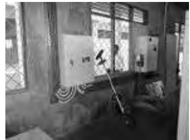
電力量計引込主開閉器 600A
