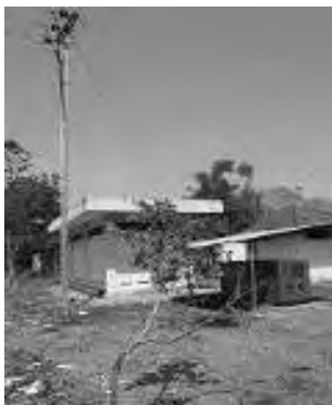
自家発電機 (故障中)
