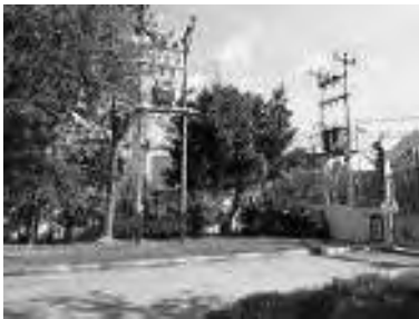
電力引込部 柱上トランス
