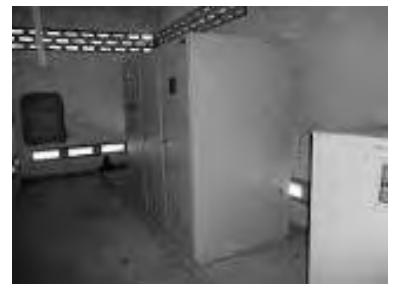
自家発電機 (故障中)
