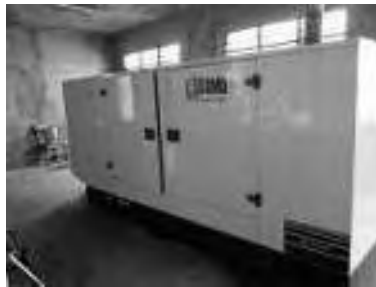
自家発電機 150kVA
