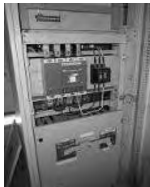
自家発電機 (故障中)
