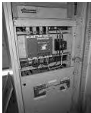
自家発電機 (故障中)
