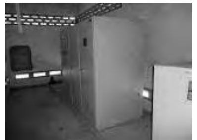
自家発電機 (故障中)
