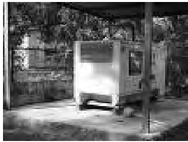
既設発電機 60kVA
