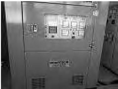
新設発電機 200kVA (未稼働)
