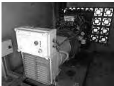
自家発電機 (用途不明)
