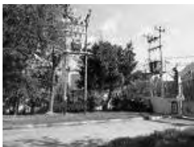
電力引込部 柱上トランス
