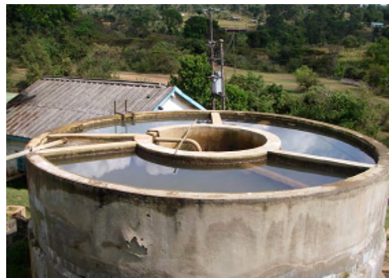
ナロク浄水場の浄水池
