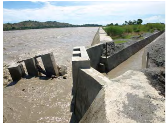
図2 - 14 2010年、半壊した取水口
