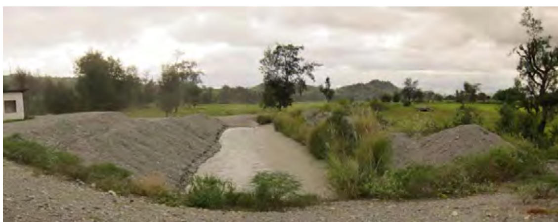
図 2 - 4 取水口直下流の幹線水路。砂利の堆積が著しい。
