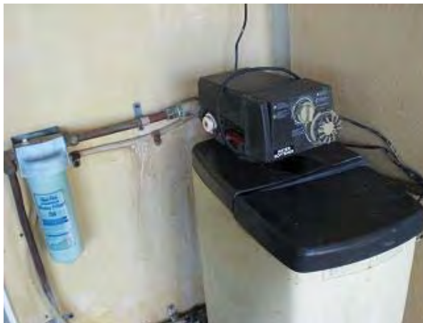
軟水器: 中央材料室の外に設置して高圧蒸気滅菌器に給水している。1998年に調達したもので、更新の時期を迎えている。
