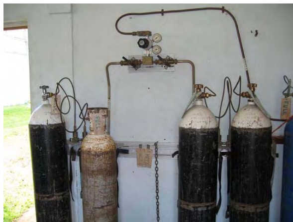
手術棟裏の医療ガス供給室内の酸素供給用マニホールド。シリンダー3本が接続されているが（うち1本はスタンバイ）供給能力は不十分。
