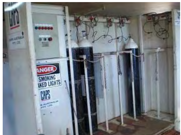
酸素発生器：10年以上を経過しており、故障が多い。ニュージーランドの代理店から交換部品を入手するので時間がかかるのも問題である。
