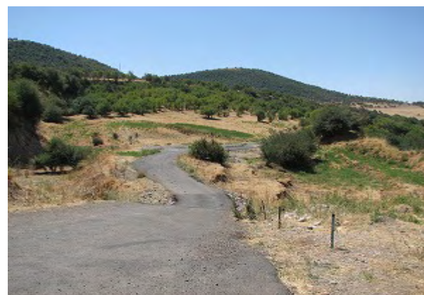
Участок для мониторинга 1(Текстильчик) Крупный оползень в Бостанлыкском районе, в верхней части наклонной поверхности находится детский лагерь. На фото изображена дорога, деформированная по причине движения оползневой массы.
