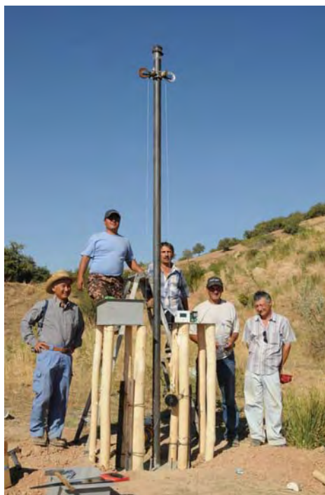
写真 10：「ウ」国で初めて設置された長スパン地盤伸縮計
