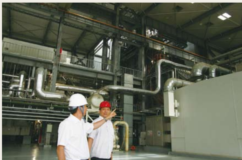
導入された新設備。近隣への騒音を考慮し、ガスタービン(右端)は巨大な箱の中に入れられている
