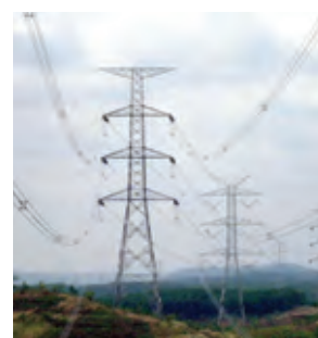
500 kV 送電線 (タシクマラヤ)
