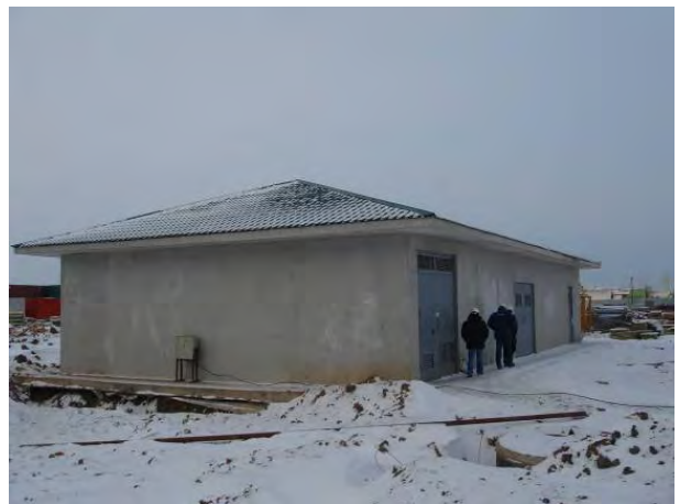
大学敷地内の受配電設備(PVシステムの接続先)
