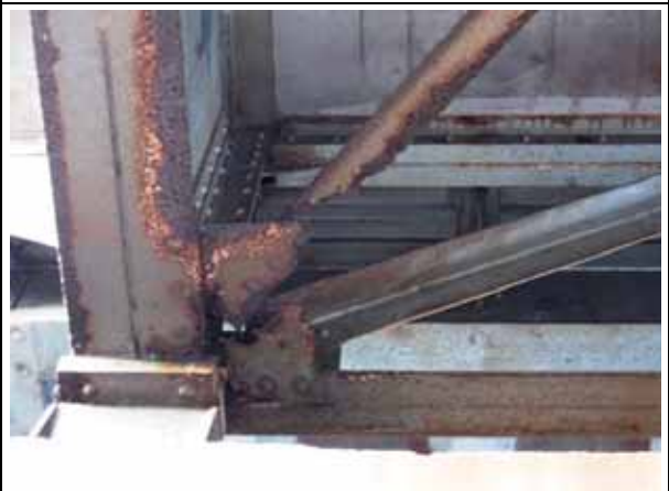
写真-18: P2 鉚桁部の鋼材は腐食により断面欠損している。
