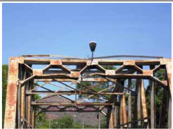
写真-26：マナグア側の橋門構は大型車輛の衝突により大きく変形している。
