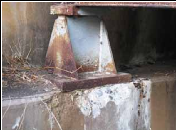
写真-15: 支承部は腐食による機能不全がみられ、橋台コンクリートは強度不足で剥落がみられる。
