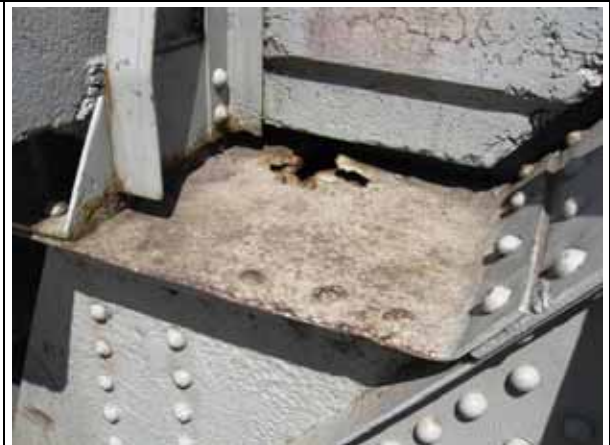
写真-12：A1 橋台支点部には、腐食による鋼部材の欠損がみられる。
