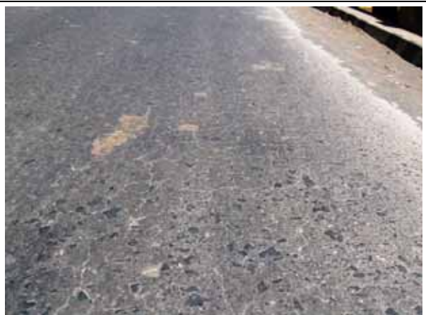
写真-30：舗装表面は多くのひびわれが発生している。
