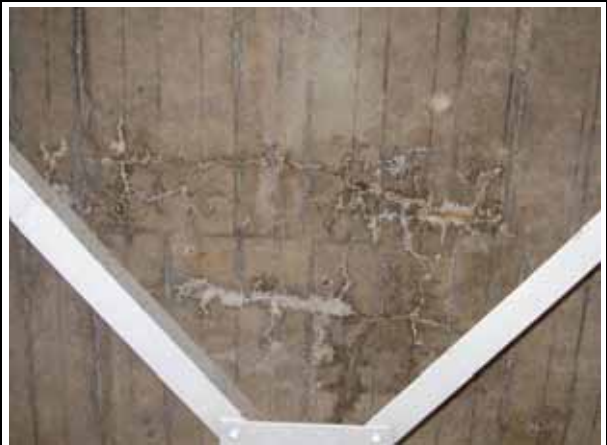
写真-16: コンクリート床版に遊離石灰及び錆汁がみられる。
