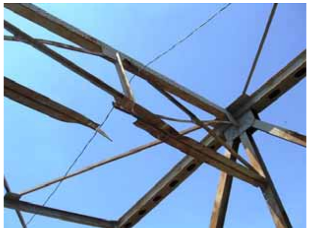
写真-28：スウェイフレームにも大型車輛の衝突による部材の破断がみられる。
