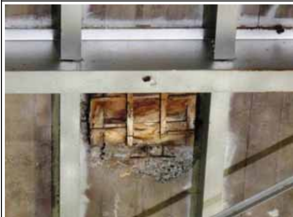
写真-29：コンクリート床版の一部は抜け落ちており、応急的な補修の跡がみられる。
