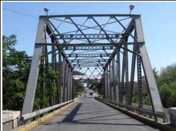
写真-9：マナグア側の橋門構は大型車の衝突により変形している。
