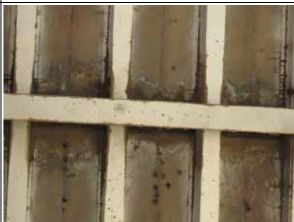
写真-22：床版コンクリートの下面にひび割れ、鋼材の腐食が見られる。
