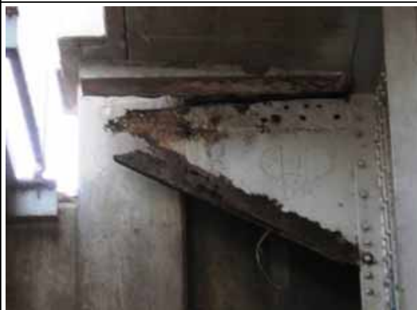
写真-17: A2 側の床版張出し部のブラケットは腐食により機能していない状況である。
