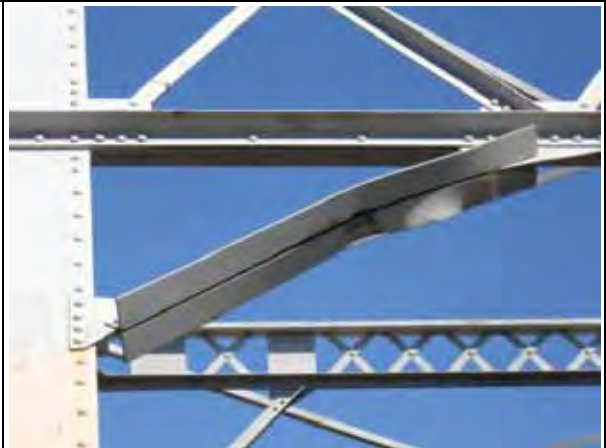
写真-20：大型車両の衝突によりトラス橋門構斜め部材が変形している。
