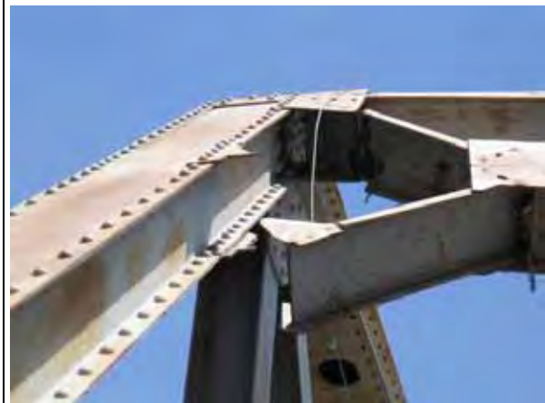
写真-27：マナグア側橋門構は部材が破断し剛性低下がみられる。
