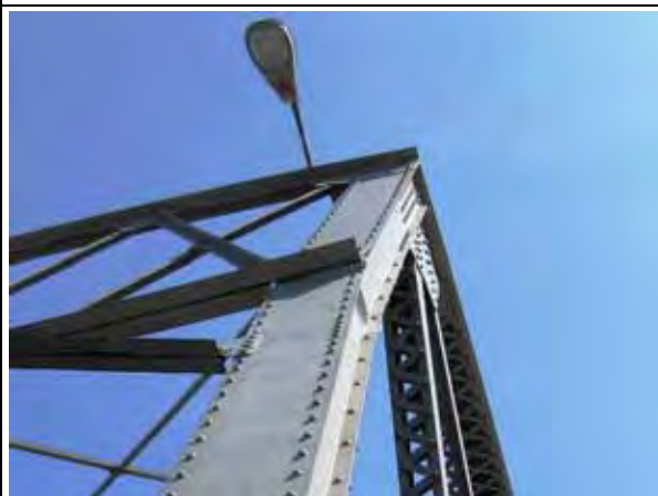
写真-10：大型車輛の衝突によって変形したは弦材も進行している。
