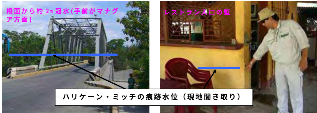
図 3-2-2-2.9 ラス・バンデラス橋のハリケーン・ミッチ来襲時の最高水位
