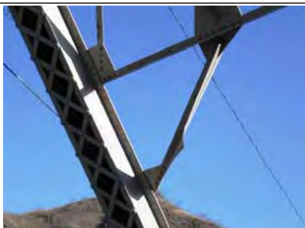
写真-14: 橋門構は大型車輛の衝突により変形している。
