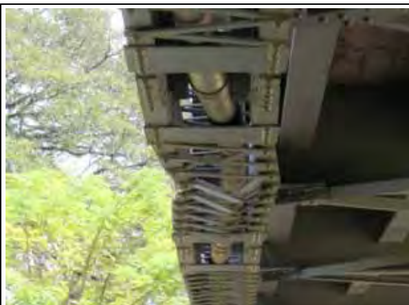
写真-8：上流側の下弦材はハリケーン・ミッチ（1998年）の際に流木の衝突で変形している。
