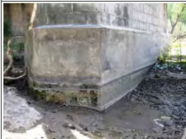
写真-11：P1 橋脚は洪水による局所洗堀がみられる。
