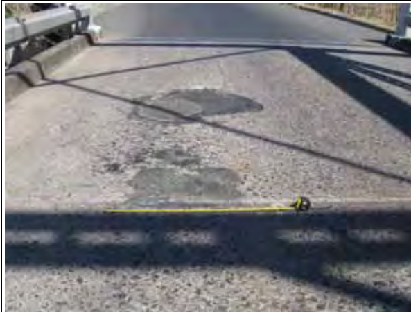
写真-21：床版コンクリート表面には損傷および補修が見られる。
