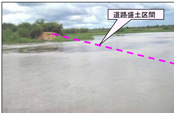
⑥ 流失した道路盛土区間 (バングラ側を見る)
