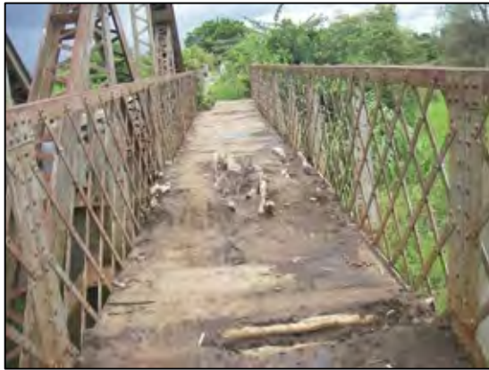
④ 劣化、損傷の著しい歩道橋
