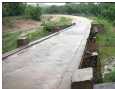
橋面の劣化及び橋脚柱部の損壊
