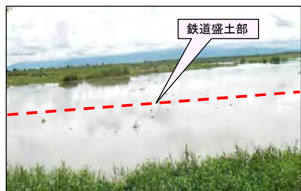
④ 流失した鉄道盛土区間
