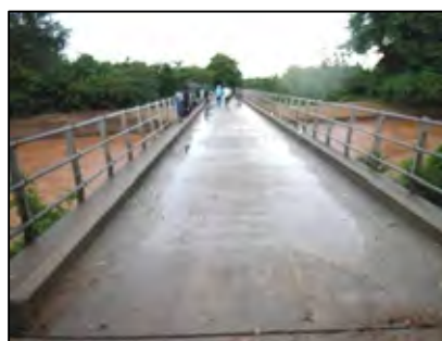
滞水している橋面
