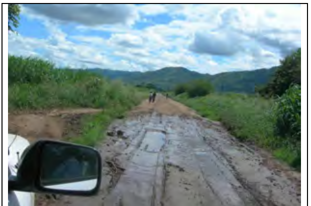
道路表層は土道で走行性は極めて悪い。
