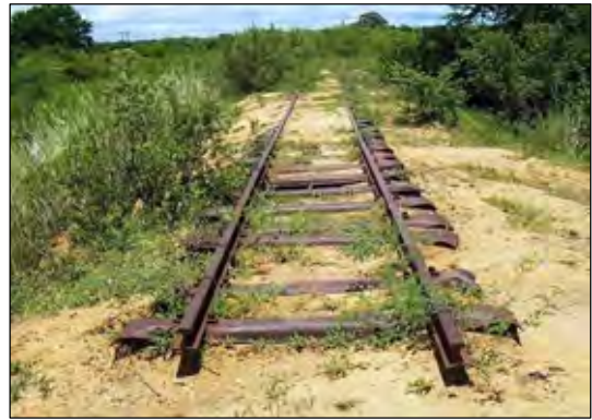
⑤ 切断され、放置されている線路
