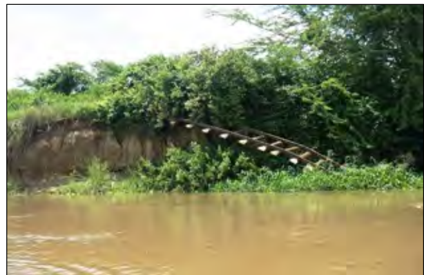
③ 崩壊した鉄道線路部
