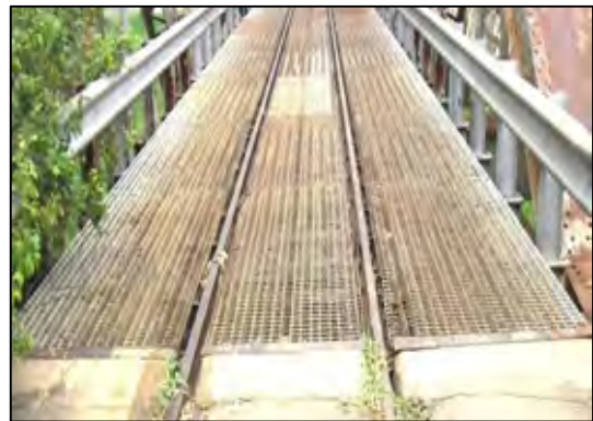
③ 耐荷力が不十分なグレーチング床版
