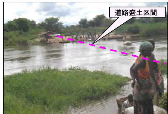
⑥ 流失した道路盛土区間 (チロモ側を見る)
