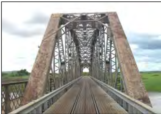
② 腐食の進むシレ橋
