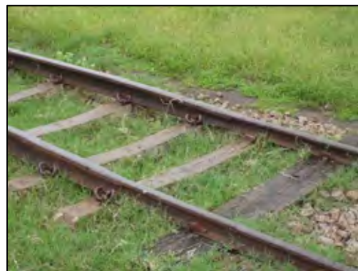
PC 枕木軌道
