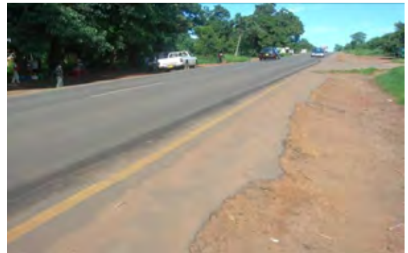
舗装厚が薄く、かつ強雨による洗掘で損傷が著しい
