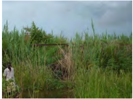
盛土崩壊区間 (チロモ駅付近)
