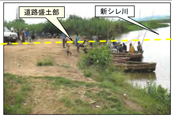
流失した道路盛土部の船着場(マカンガ側)
