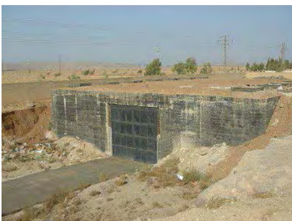
使用済み蓄電池保管庫
