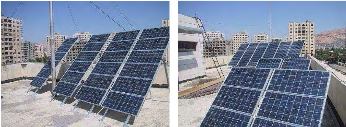
図 1-1 NERC 庁舎屋上に設置された太陽光発電システム
