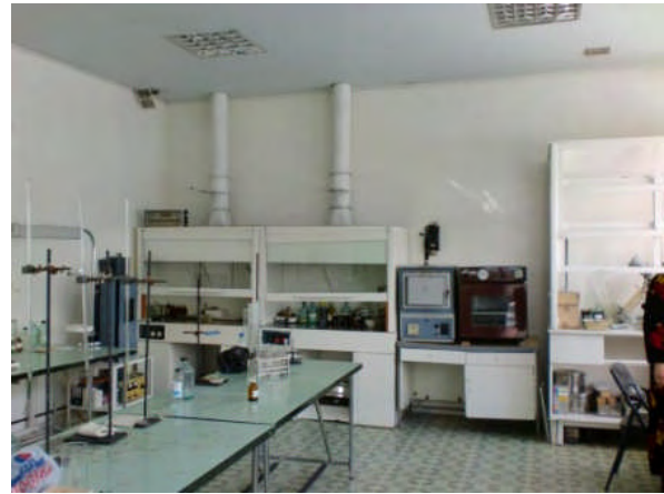
写真 3-44 試験室； 排気設備
