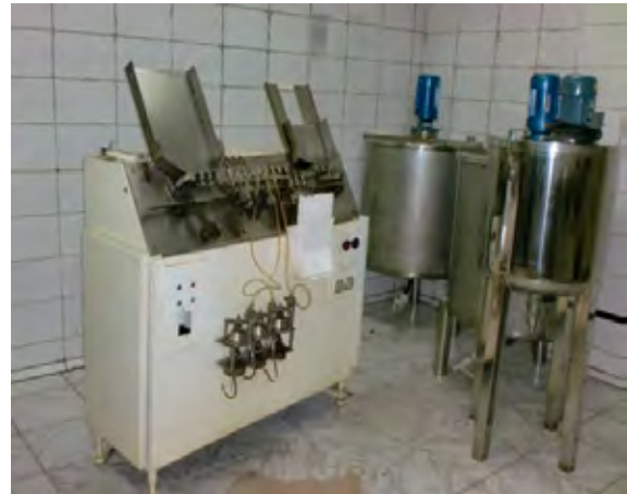
写真 3-50 無菌室； アンプル充填機
