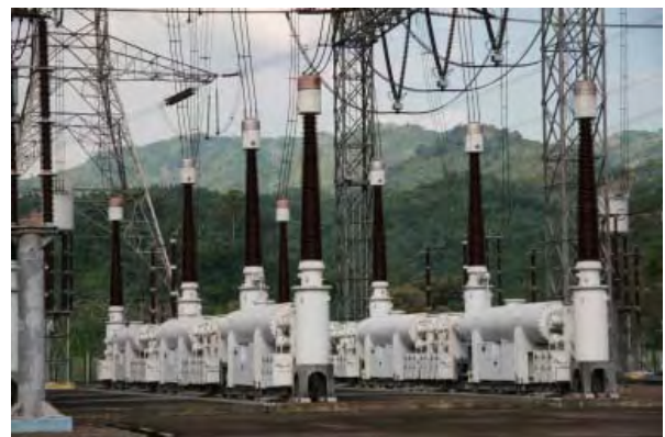
GIS type Switchgear
