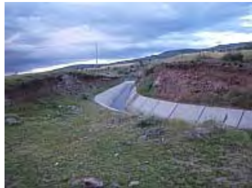
図 5.2.1 Cachi 川特別事業上流地区灌漑水路
