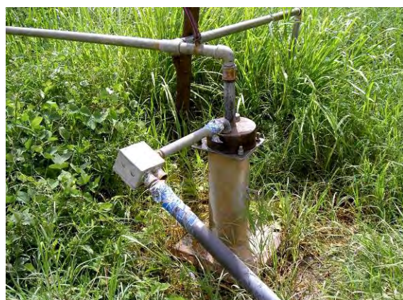
深井戸(手前は配線の管、家畜用と貯水タンクに分流)
