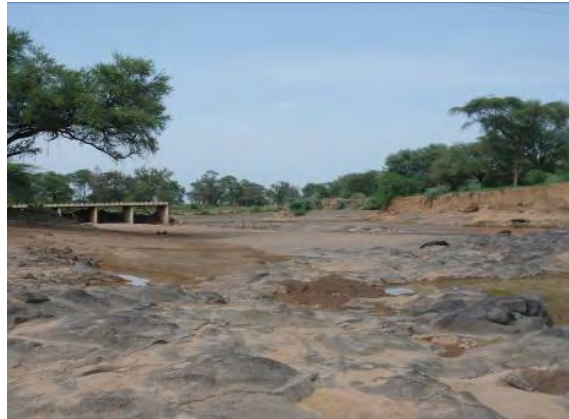
主要道路の橋が洪水で流されている
