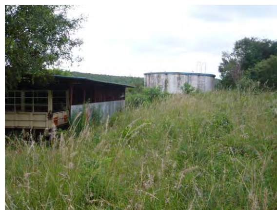
風力ポンプの近くにある地上式配水池 無風時を考慮して施設は3日分の容量である。
