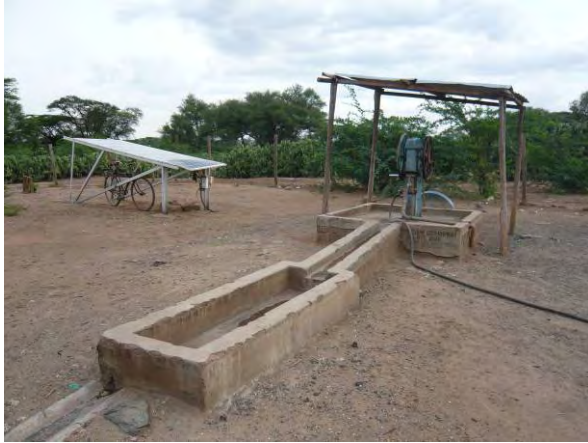
Kambi Turkana 村 太陽光式レベル 1.5 施設 ベルギーが 2005 年にベルギー製の回転式ハンドポンプに DC モーターを取り付け、改造した施設
