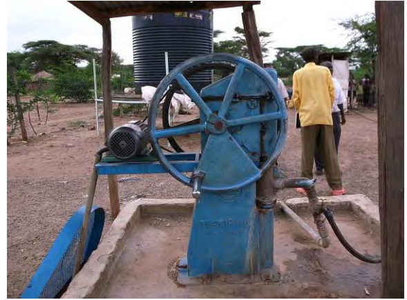
同左拡大。ベルギー製ハンドポンプ DC モーターの据付状況。動力を電動化しただけで、揚水量は変わらない。
