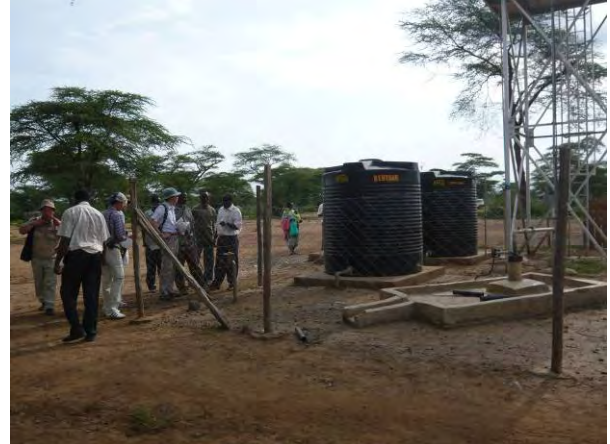
同左。下部のタンクはフッ素除去施設（2 基） 1 基目は効果が無くなり 2 基目を増築。 フッ素除去効果を確認（処理前 3mg/l→後 0.2mg/l）
