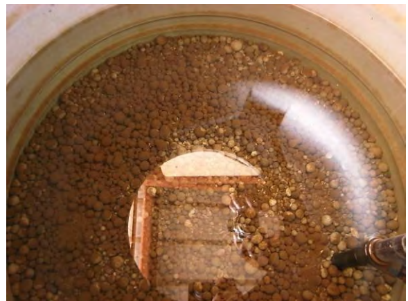
同上。幼稚園に設置された飲料用水タンクの内部状況。 粒状にされた家畜の骨炭が詰められている。
