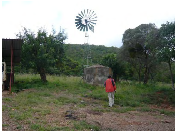
Churo 村 風力を利用した既存施設 UNDP が 2005 年に建設。貯水槽 2 基。 学校用（生徒+先生、約 150 人）
