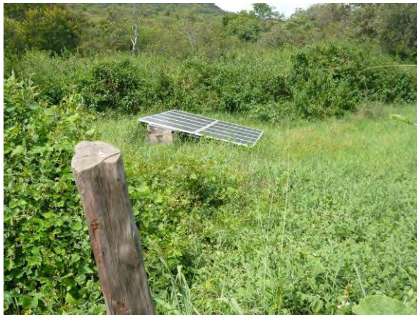
Chebinyiny 村 太陽光式レベル1.5 施設 2000～2001 年に日本の無償で設置したハンドポンプを ソーラーポンプに改造された施設 (70%の政府資金と 30%の村民負担)
